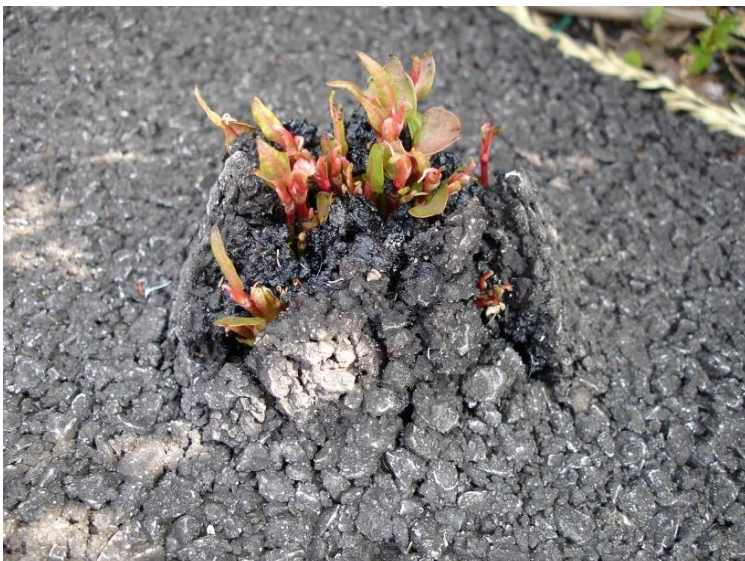
Schade door de Japanse duizendknoop aan het asfalt (foto: internet)
